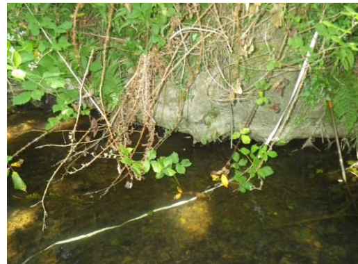
Présence d'une sous-berge
